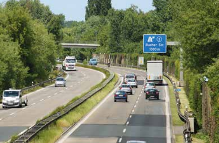
Straßenschäden wurden nur kleinteilig ausgebessert. Ein Standstreifen fehlt bisher.
